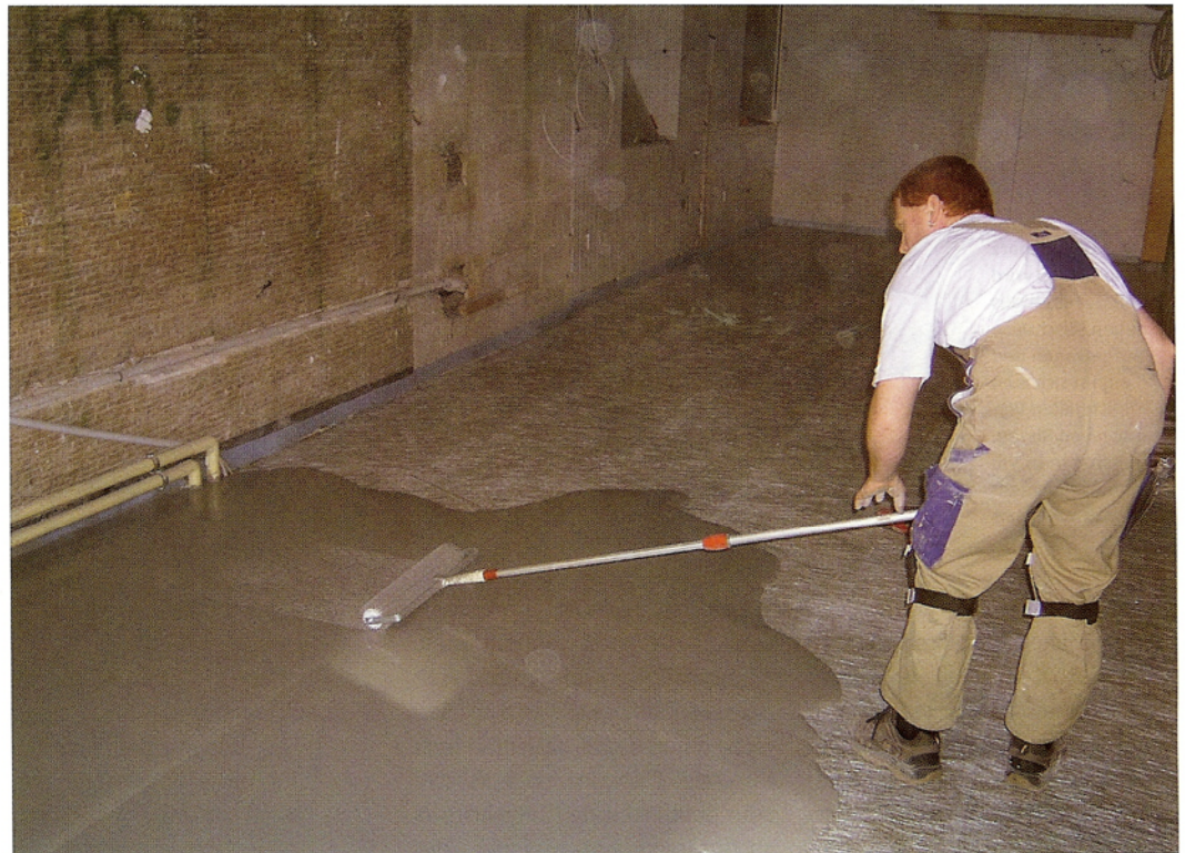
■ Entlüften des über der lose verlegten Armierungsmatte aufgeschütteten Fliessestrichs mit der Stachelrolle.
